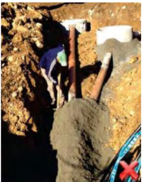
Canalisation bétonnée seulement en-dessus !
