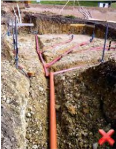
Canalisations SANS assise bétonné !
