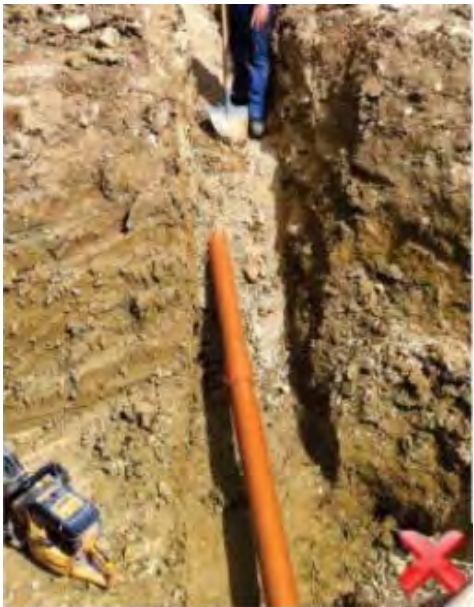
Canalisation non bétonnée !
