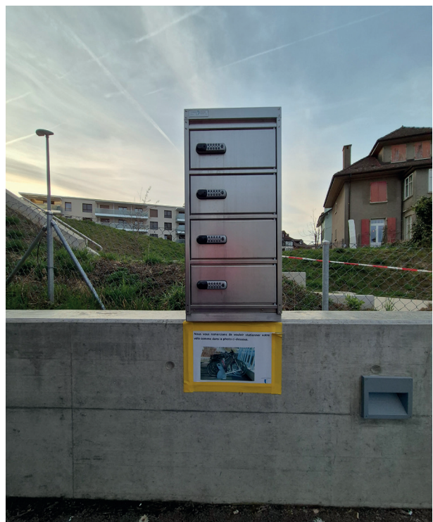
Armoire de recharge d'accus pour vélo électrique. Source: Commune de Cossonay
