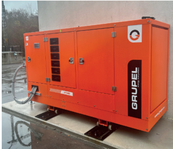
Nouvelle génératrice de la step. Source: Commune de Cossonay
