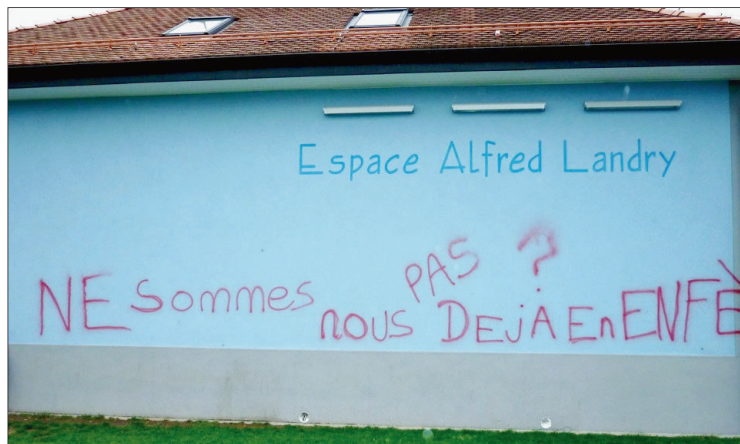
Déprédation d'un bâtiment communal.
