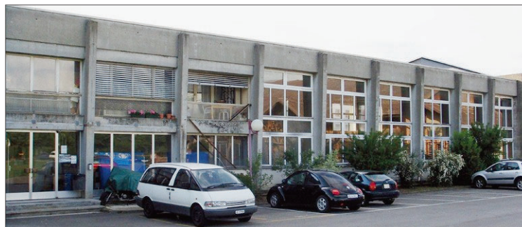
Le bâtiment du Passoir est très vétuste.
