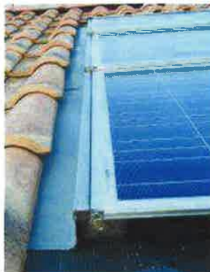
Panneaux solaires bien intégrés dans le toit.
